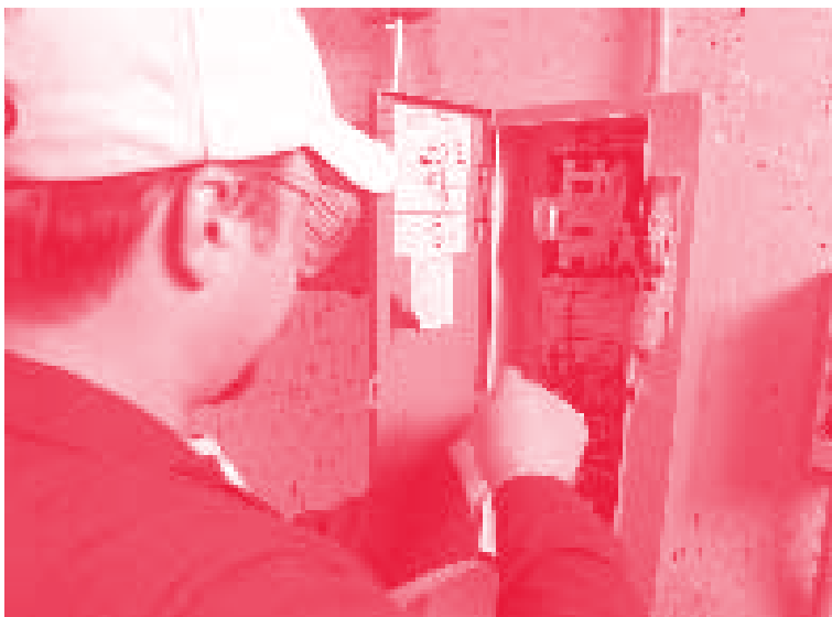
Χρησιμοποίησε διατάξεις προστασίας για το επιπλέον ρεύμα (αυτόματες ασφάλειες ή τηκόμενες ασφάλειες) στα κυκλώματα.
